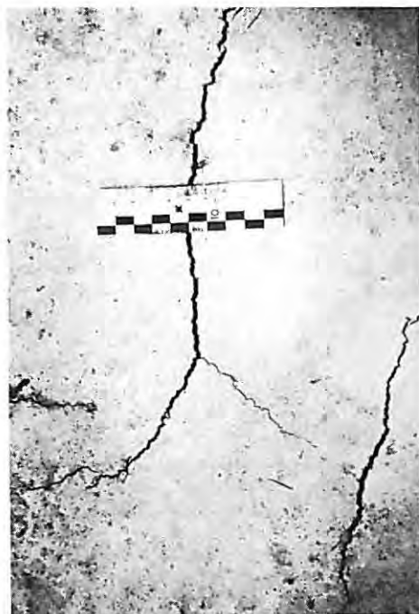
Bild 1 Schrumpfrisse in einer Betondecke
