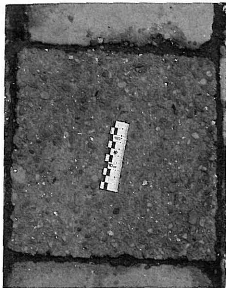
Bild 2 Abwitterung der Feinmörtelschicht an der oberen Fläche einer Platte durch Frost- und Tausalz-Einwirkung
