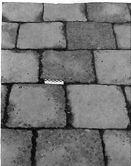
Bild 1 Gehweg mit unregelmäßig abgewitterten Platten
